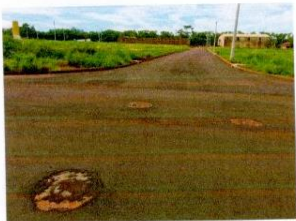
Foto 05: água e esgoto “poço de visita”
