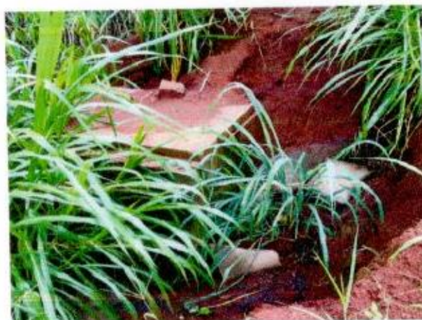
Foto 08: caixa para água pluvial
