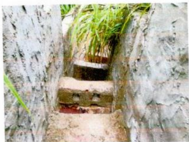
Foto 07: dissipador de energia “água pluvial”
